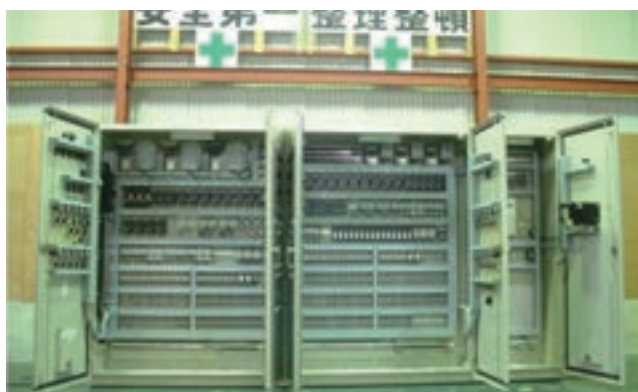
国府町納め 水処理制御盤
