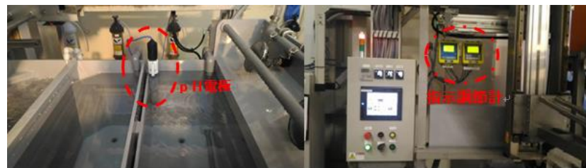
写真1(左) 水洗槽に設置されたpH電極の様子 写真2(右) 操作盤付近設置された指示調節計の様子
