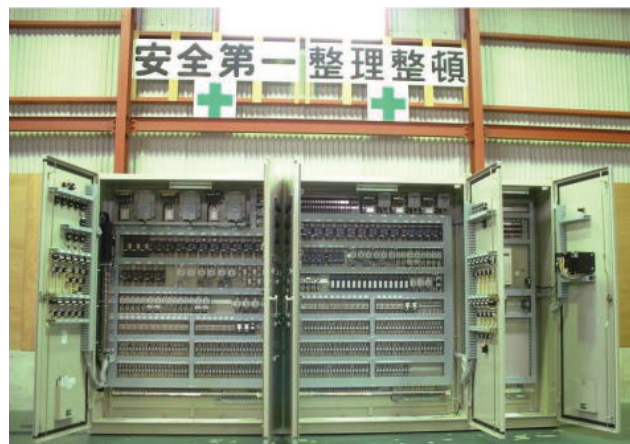
国府町納め 水処理制御盤
